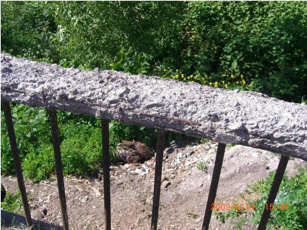
1. ábra: Fagykárosodott vasalt beton hídkorlát
