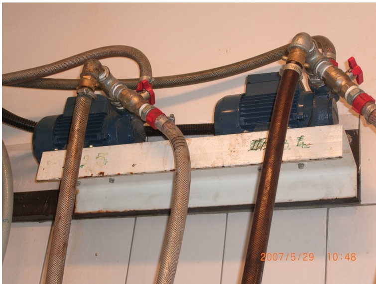
1. ábra: Adalékiszerszivattyúk a Holcim Hungária Zrt. Kőbányai Betongyárában
