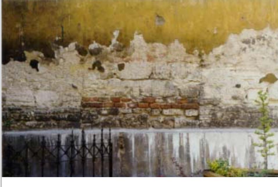
Vakolatleválás a homlokzaton
