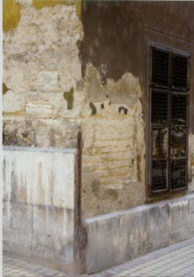
Vakolatleválás a homlokzaton
