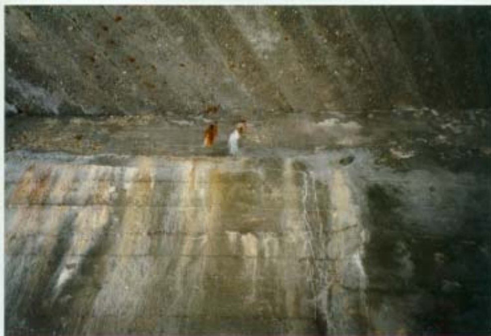
10. sz. kép Vízfolyások a szerkezeti gerenda alatti munkahézagnál
