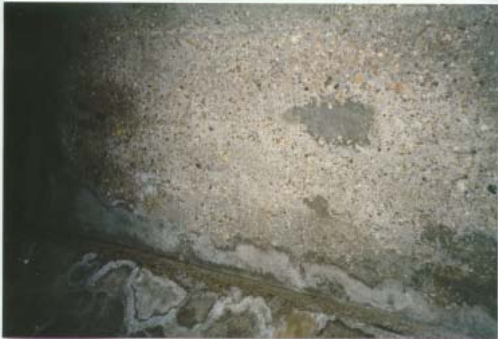
6. sz. kép A korábban épült falszakasz szemcsehiányos felülete
