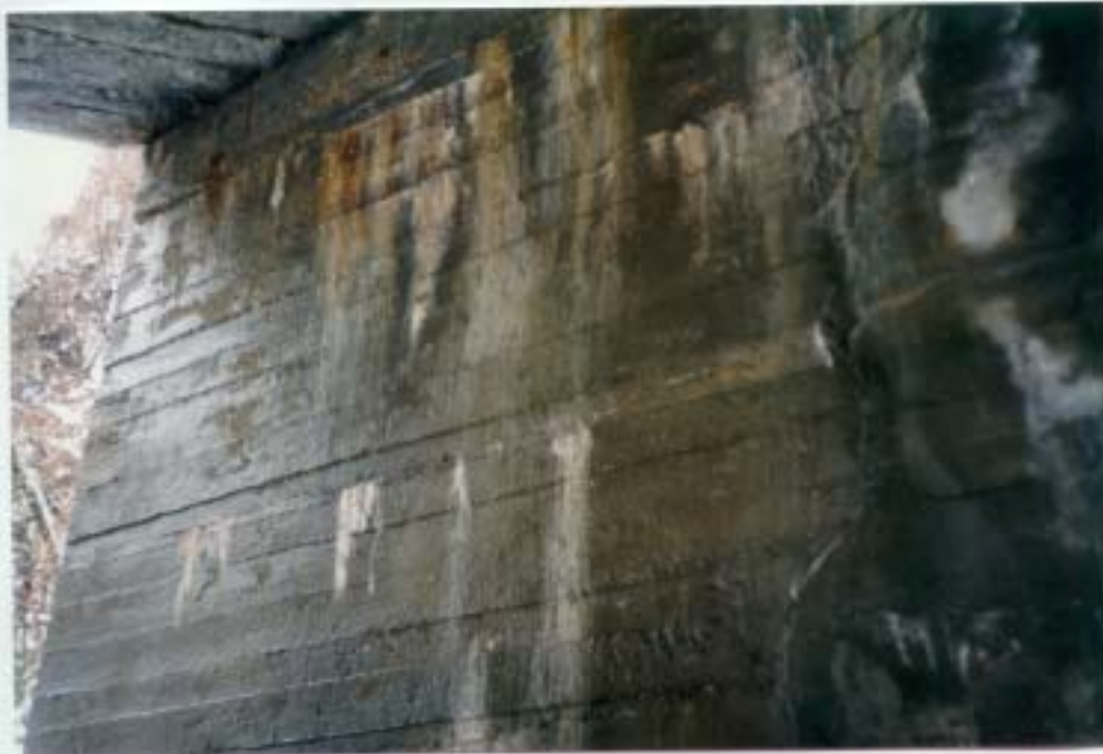
9. sz. kép A bal oldali régi-új falszakasz Esztergom felőli nedves csatlakozása
